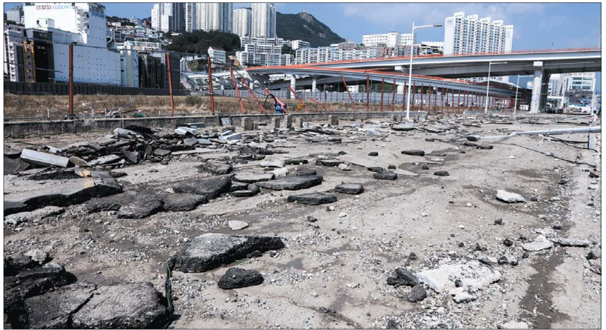
사진은 지난 2016년 10월 태풍 차바로 도로 침수 및 파손 피해를 입은 등대로 일원의 모습.
